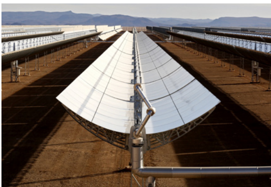
Painéis solares da megainstalação solar de Uarzazate, no sul de Marrocos, construída por um consórcio espanhol.
