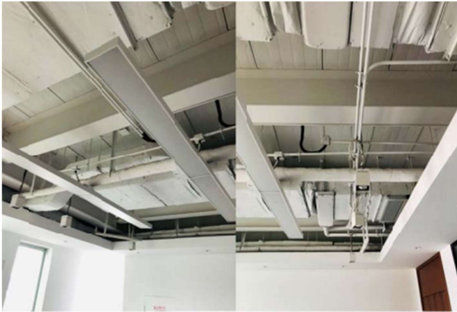
照片 25 和 26: 大厅天花板。可见空调装置（含管道、进风口和出风口）、长条悬挂灯具、电气装置和聚光灯及探测器。
