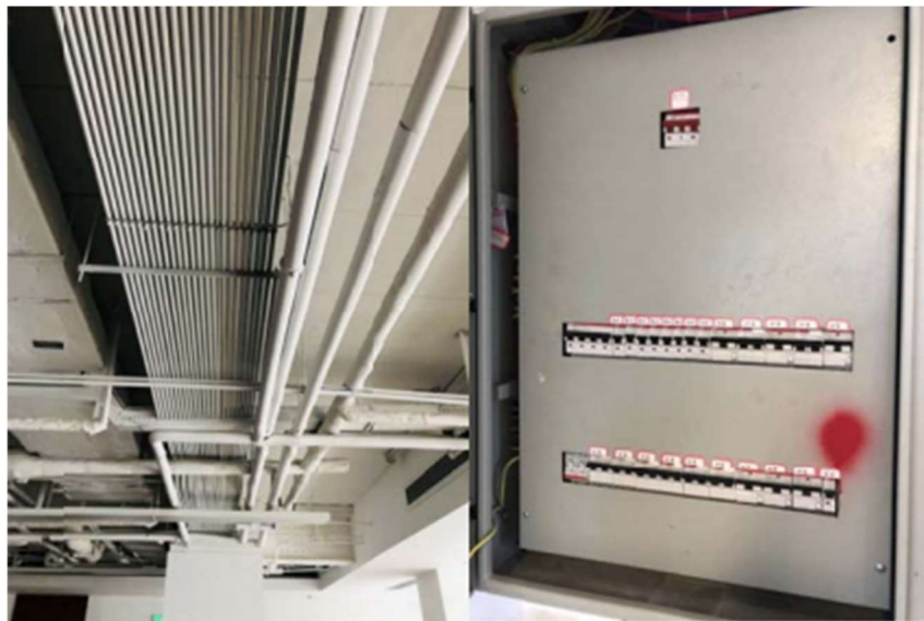
照片27和28: 电气装置, 位于由悬挂结构支撑的刚性管内。照片 28, 总配电箱。全中文标识。配电盘的容量大概已满, 需要为通讯室增加扩展配电箱
