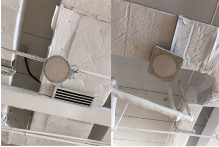
照片 29 和 30: 第一张照片可见烟雾探测器, 位于最里面, 第一层为一个探测装置。在照片 30 中, 大概是一个网络信号增强调制解调器。30 显示的是网络信号增强调制解调器及消防喷水扩散器。
