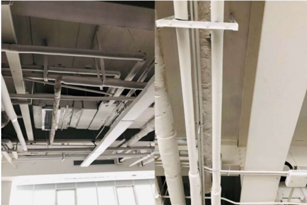
照片 30 和 31: 空调设备位于顶部, 供水管道位于不同板层。室内分接电路桥架位于最底层。在照片 31 中, 管道没有颜色或材料区分, 均涂成白色。
