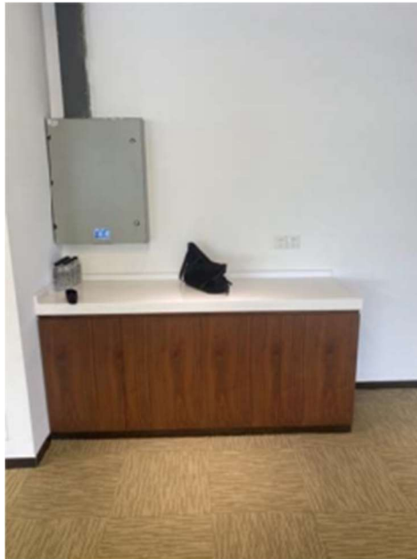
照片14：大厅。配电箱及柜台。
