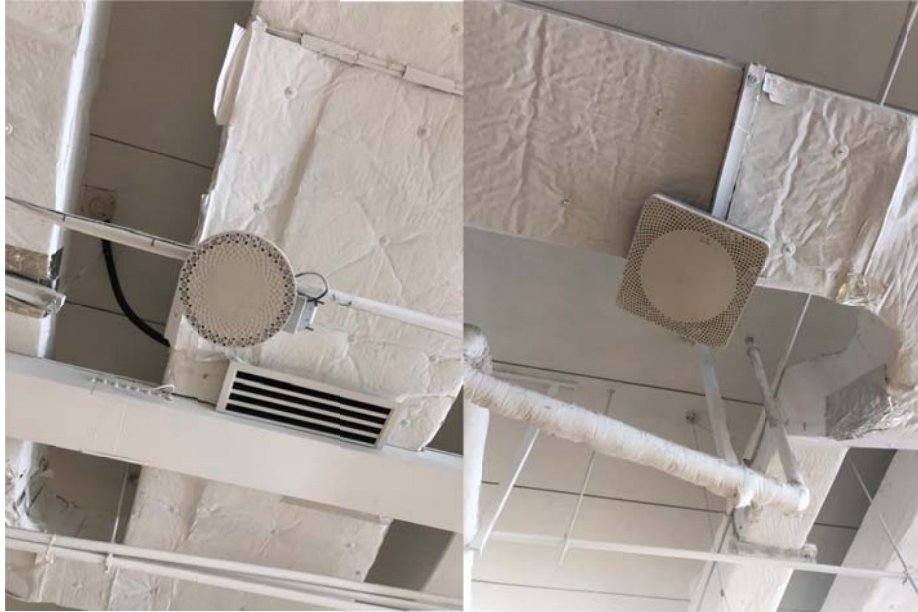
Fotografías 29 y 30. En la primera se observa el detector de humos en la parte más profunda y en primer plano un dispositivo de detección. En la fotg. 30 parece un modem de ampliación de señal de internet, así como los difusores de agua del sistema de protección de incendios.
