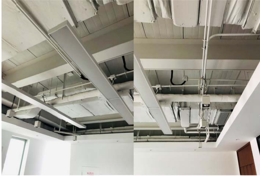
Fotografías 25 y 26. Techo e sala general. Se observa instalaciones de aire acondicionado con conductos para bocas de inyección, conductos para bocas de retorno, luminarias colgadas de tipo lineal, instalaciones eléctricas e instalaciones de iluminación puntual, así como detectores.
