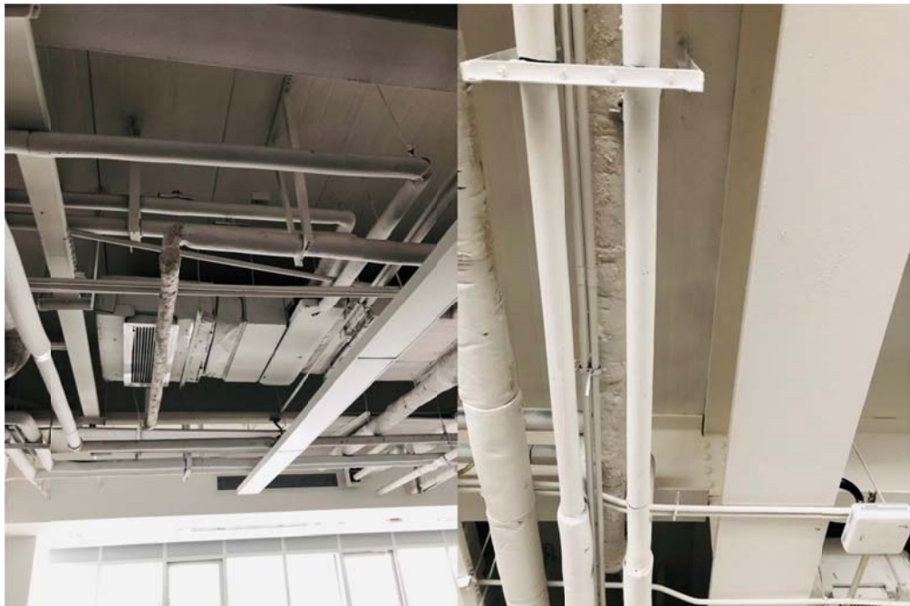
Fotografías 30 y 31. Se observan las instalaciones de aire acondicionado en la parte superior y las tuberías de suministro en diferentes capas. La bandeja de instalaciones eléctricas que viene de la acometida del local está en el nivel más inferior. En la foto 31, descuelgue de tuberías no hay discretización por colores o materiales, al estar todo pintado en blanco.
