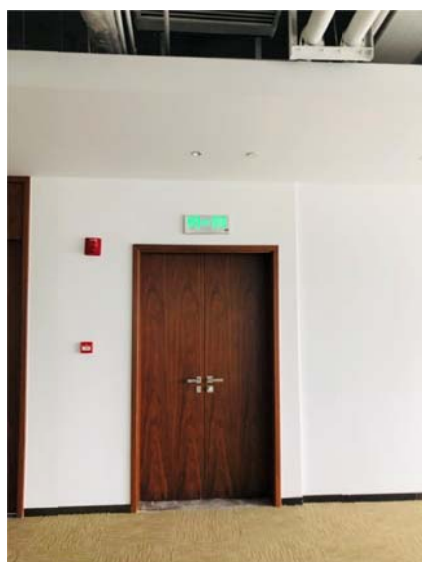
Fotografías 24. Salida de evacuación de incendios directamente desde el local. Puertas acabado en madera, pero de imitación (tipo melanina impresa). Se observa pulsador de alarma, señalítica de evacuación y dispositivo de sonido de alarma.
