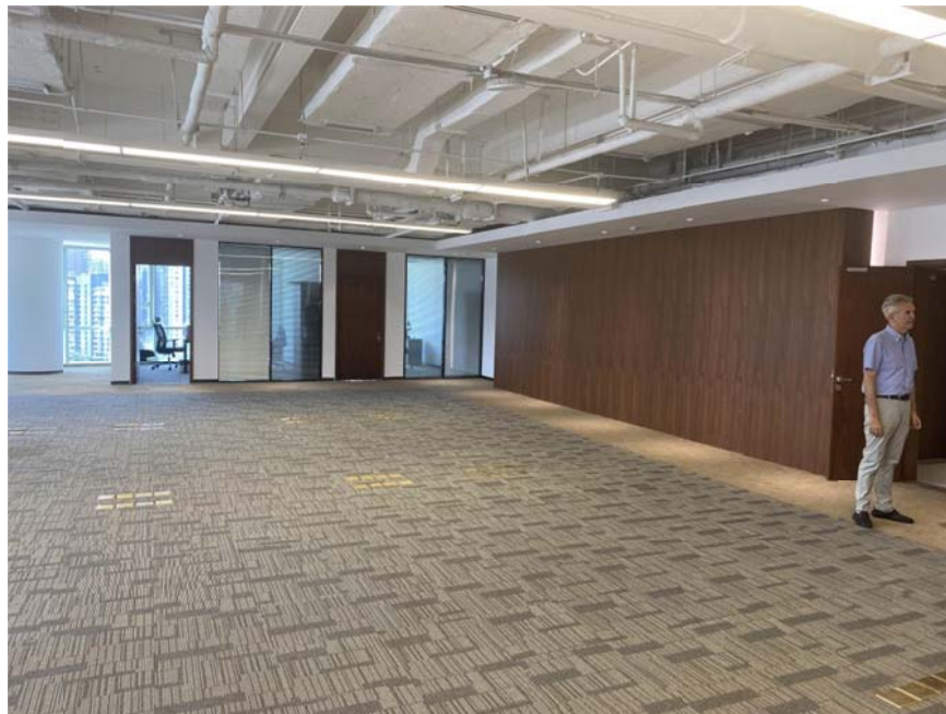
Fotografía 13. Sala general. Vista hacia los despachos de Secretaría General y Cancillería. Se observa una panelado de imitación madera que cubre instalaciones de evacuación de agua del sistema de aire acondicionado, así como acceso de otras instalaciones eléctricas.
