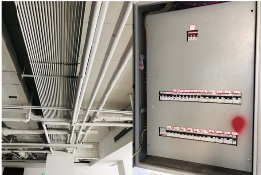
Fotografías 27 y 28. Instalaciones eléctricas en tubos rígidos soportados por estructura colgante. Fotog. 28, cuadro metálico general. Está todo etiquetado con nomenclatura en chino. Parece que la capacidad del cuadro está cerrada, lo que significará que para sala de informática será necesario ampliar con un cuadro de ampliación adicional.
