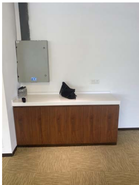
Fotografía 14. Sala general. Cuadro general eléctrico y bancada de oficio.
